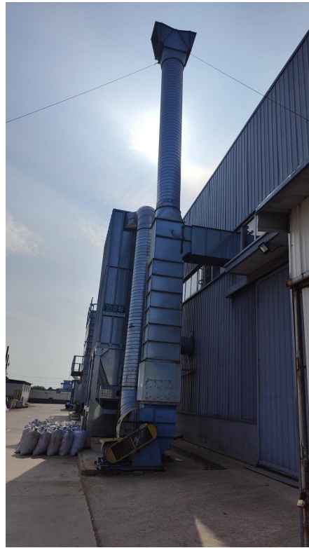
2#布袋除尘器及排气筒（DA006）照片
