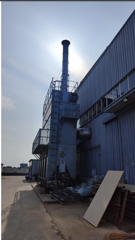
1#布袋除尘器及排气筒（DA001）照片
